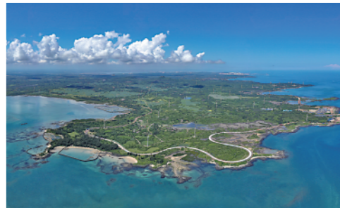
这是7月23日拍摄的海南环岛旅游公路儋州段施工现场。海南环岛旅游公路预计2023年底前全线通车。新华社记者郭程摄
