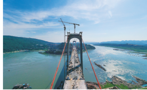
正在进行桥面施工的重庆郭家沱长江大桥(7月12日摄)。大桥通车后,将有效缓解中心城区路网拥堵。新华社记者刘潺摄
