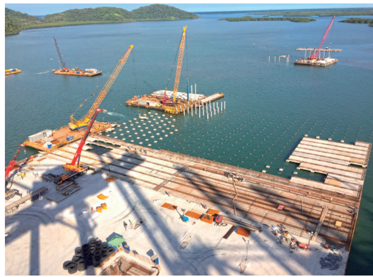
▲(2018年8月27日摄)西巴那瓜港口码头扩建工程现场。新华社记者彭梓摄
