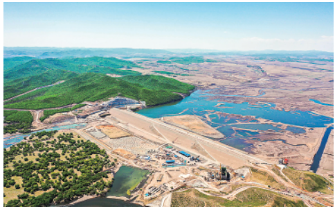
近日,内蒙古自治区引绰济辽工程有序推进,工人们在现场加紧施工(5月21日摄)。新华社记者刘磊摄
