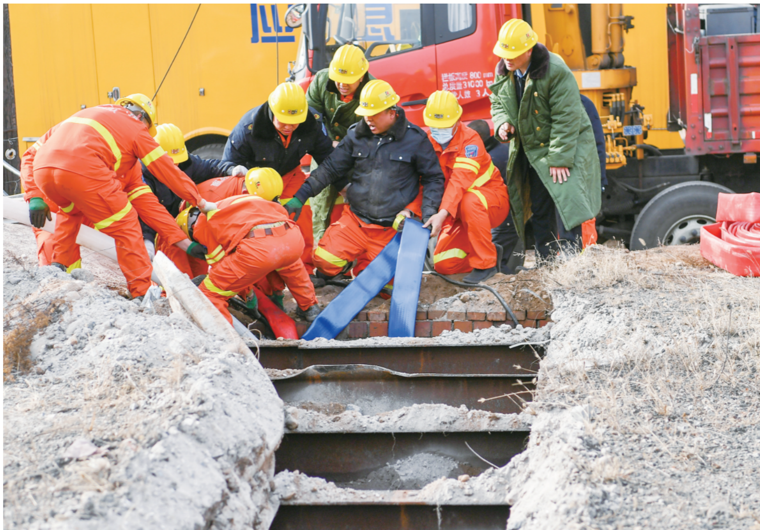
这是12月16日在山西省孝义市西辛庄镇杜西沟村拍摄的救援现场。
