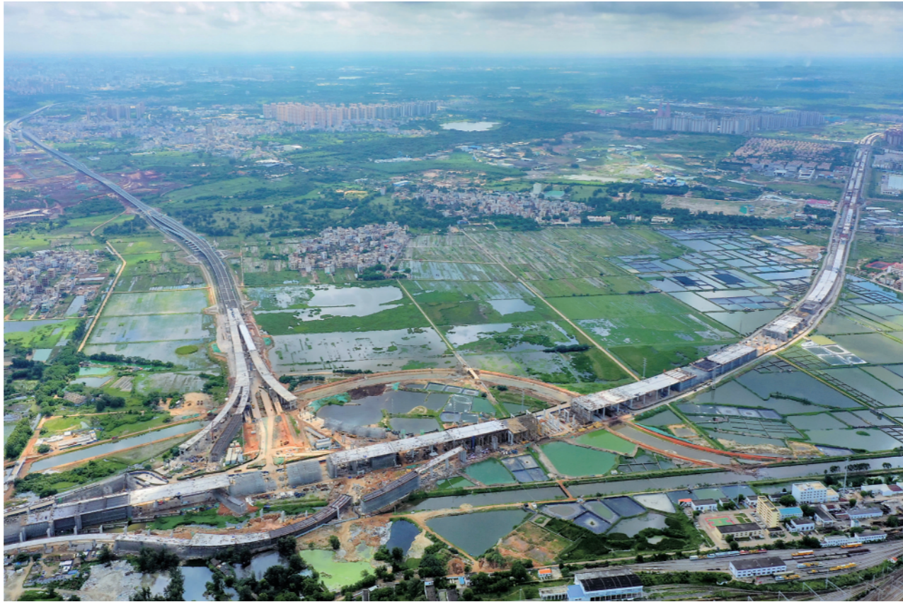
9月2日拍摄的沈海高速海口段项目施工工地(无人照片)。G15沈海高速公路海口段是G15沈海高速和G75兰海高速在海南的“最后一公里”，也是海南省高速公路连接全国高速公路网的唯一通道，路线全长13.727公里。目前，G15沈海高速公路海口段项目主体工程已完成60%，计划在2022年底建成通车。 新华社记者 郭程摄
