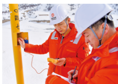
管道巡护人员在测试阴极保护电位电压。
