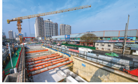
近日,由中建三局承建的成都轨道交通27号线一期工程金府站主体结构顺利封顶。 新华社记者王曦摄
