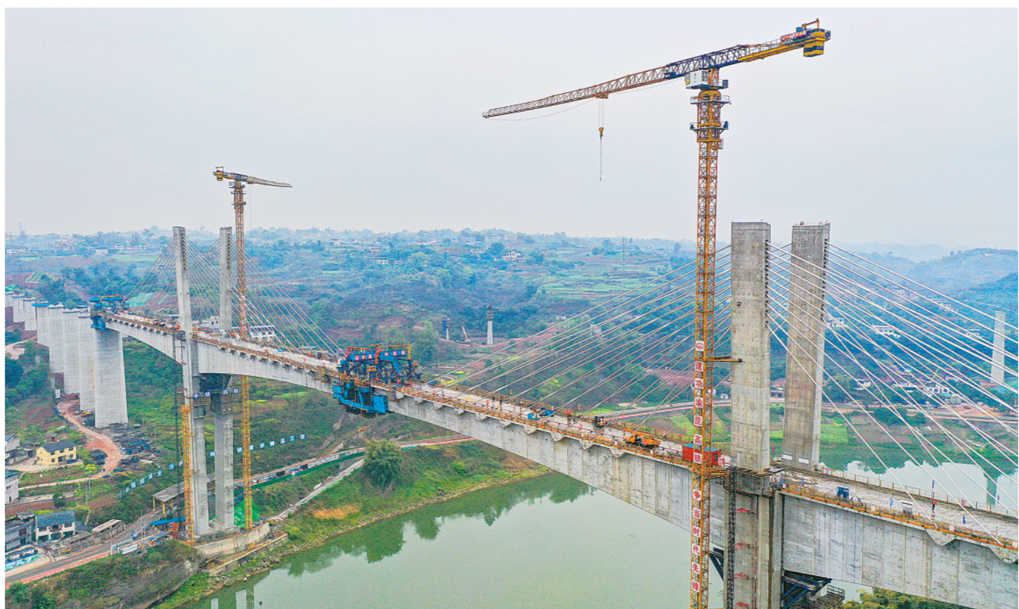
▲3月18日在四川省泸州市拍摄的渝昆高铁泸州沱江特大桥主跨合龙施工现场。
