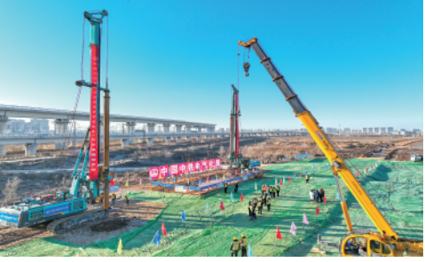
2月25日，雄忻高铁雄保段全面进入主体施工阶段。雄忻高铁雄保段正线全长54.34公里。新华社记者牟宇摄
