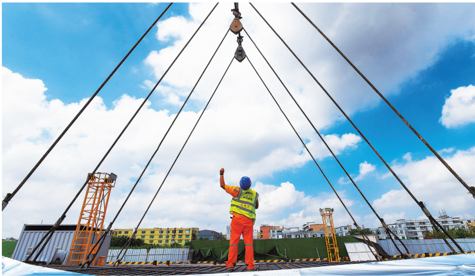
▲10月3日,中铁十一局的工人在广花城际铁路白云城市中心站施工。国庆假期,建设者们坚守岗位,奋战在施工一线,确保工程建设进度。
