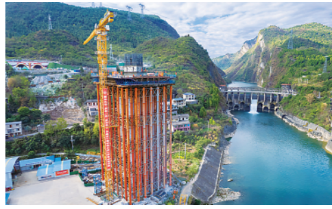
10月2日,在湖南桑龙高速贺龙特大桥建设现场,中铁五局工人在施工作业。 新华社记者陈思汗摄
