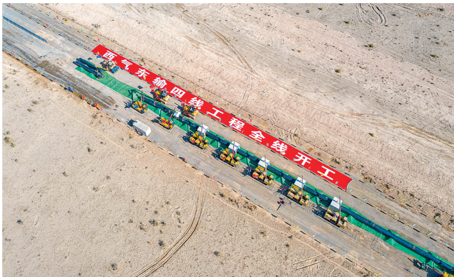
▲这是9月28日拍摄的西气东输四线工程开工现场。当日，国家管网集团西气东输四线工程正式开工，工程起于新疆乌恰县，止于宁夏中卫市，管道全长约3340公里。西气东输四线工程建成后将与西气东输二线、三线联合运行，届时西气东输管道系统年输送能力将达到千亿立方米，进一步完善我国西北能源战略通道，提升我国天然气管网系统的管输能力，增强系统供气可靠性和灵活性，提高能源输送的抗风险能力。
