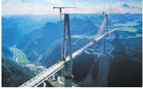
8月19日,龙里河大桥顺利合龙。龙里河大桥位于贵州省龙里县境内,全长1260米。新华社记者杨文斌摄
