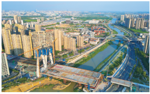
8月7日,由中铁四局承建的引江济淮工程江淮沟通段金寨南路桥主桥贯通。 新华社记者刘军喜摄
