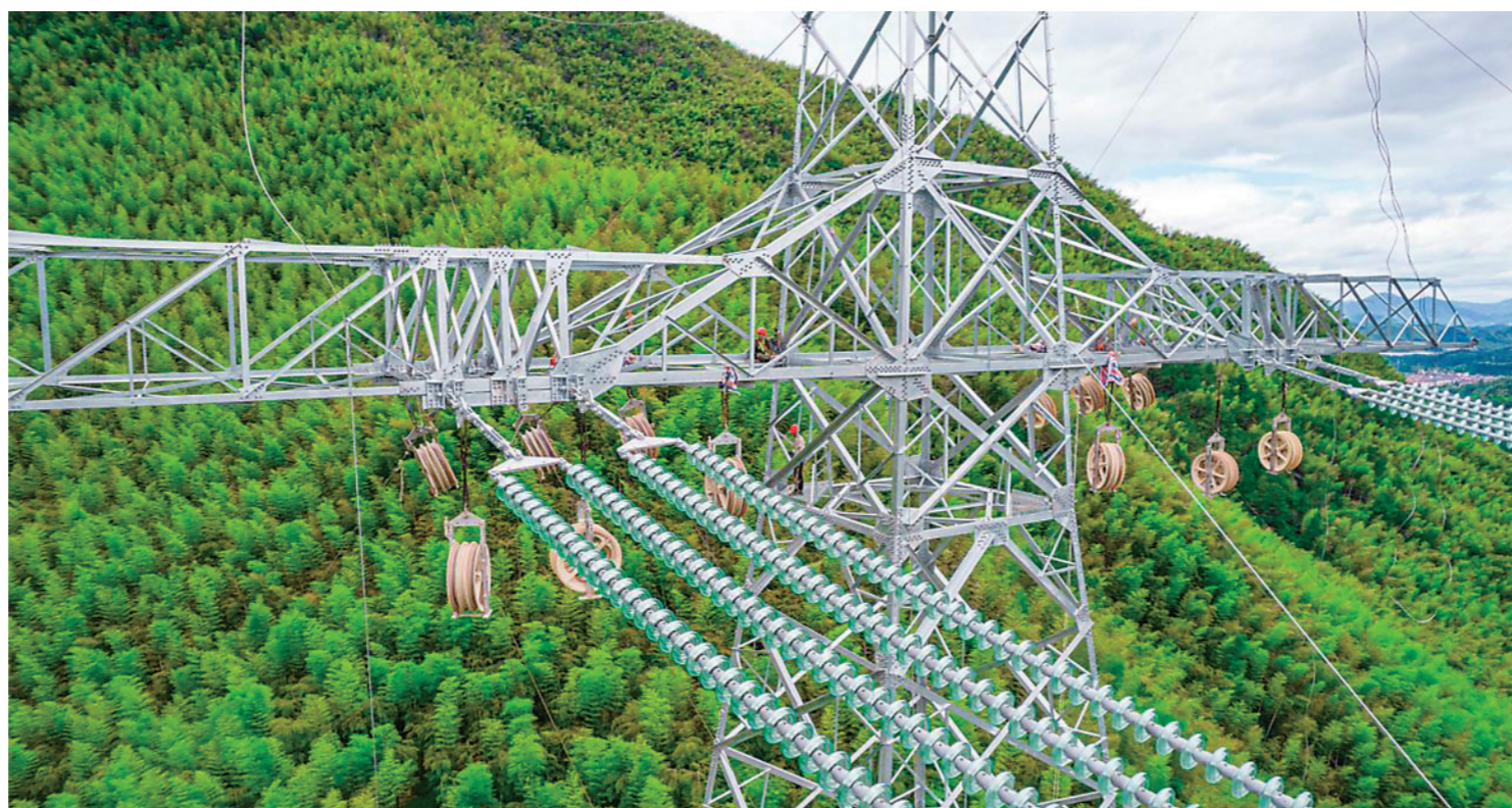
▲6月27日,白鹤滩-浙江±800千伏特高压直流输电工程浙江湖州安吉段线路安装完毕,提前一个月全部贯通。
