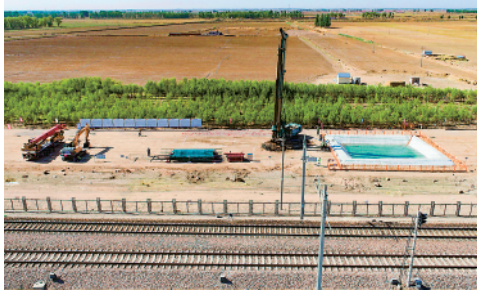
近日，包(头)银(川)高铁跨海勒大斯沟特大桥开始施工，标志着包银高铁内蒙古段主体工程进入建设阶段。新华社发(王正摄)
