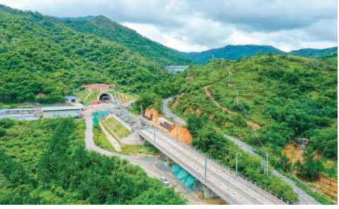
5月30日，广汕高铁迎牌山隧道顺利贯通，至此广汕高铁全线所有隧道全部贯通。新华社记者刘大伟摄
