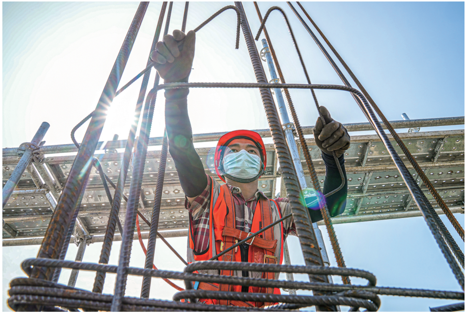
▲4月24日，中建三局一公司的工程人员在项目现场施工建设。 近期，江苏省南京市各工业主体认真落实疫情防控和安全生产责任，一手抓疫情防控，一手抓生产建设。在南京市建邺区小米集团华东总部项目，中建三局一公司相关项目部严格落实常态化疫情防控措施，确保工程不停工，项目建设如期稳步推进。 新华社记者李博摄
