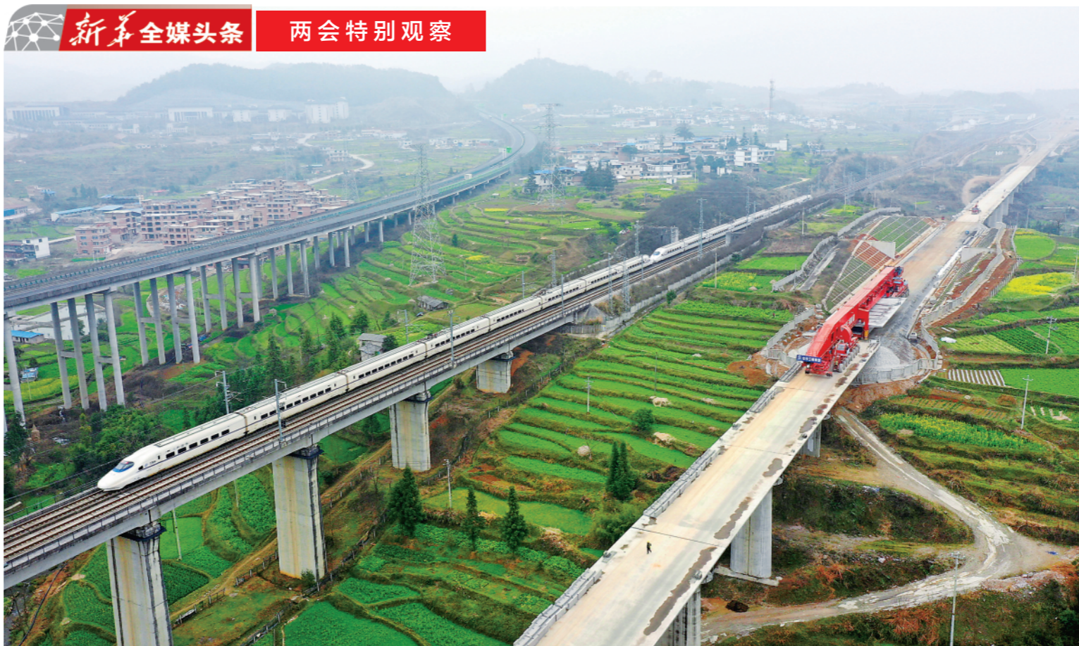
▲3月5日，运梁车在贵南高铁(贵州段三标)马寨双线特大桥(图右)运送箱梁(无人机照片)。目前，由中铁十一局等单位建设的贵(贵阳)南(南宁)高速铁路施工进度顺利，各项工程有序推进。贵南高铁设计时速350公里，是我国“八纵八横”高速铁路主通道包头至海口通道的重要组成部分。新华社发(肖伟摄)
