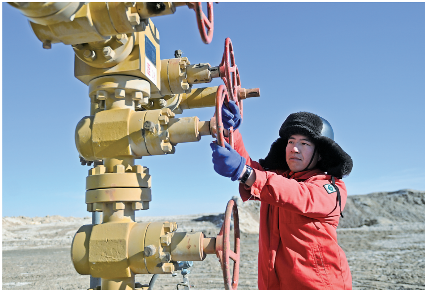
▲1月26日,在中国石油天然气集团公司青海油田公司采气一厂,工人拧紧装置阀门。
