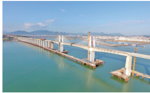
11月13日,新建福州(州)厦门铁路跨海大桥成功合龙,新建福州铁路关键控制性节点顺利打通。新华社记者林善摄
