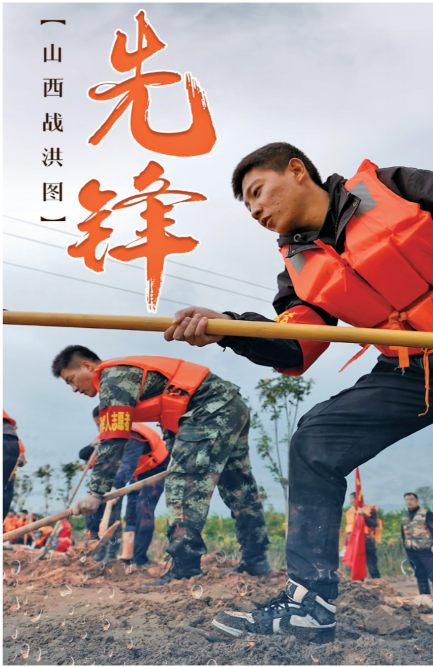
河堤决口，铁路路基被冲垮，公路被阻断……打通交通生命线，抢险救援工作连夜展开。10月6日10时许，太原工务段
