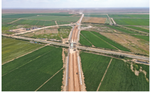
截至7月中旬,S21阿勒泰至乌鲁木齐高速公路二期工程底基层施工已经完成,力争年内完成建设(7月16日摄)。新华社记者高晗摄
