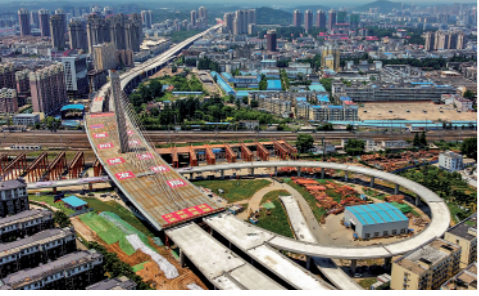
6月22日,河南省信阳市跨京广铁路斜拉桥成功转体。转体主梁总长291米,总重量达1.96万吨。新华社记者朱祥摄
