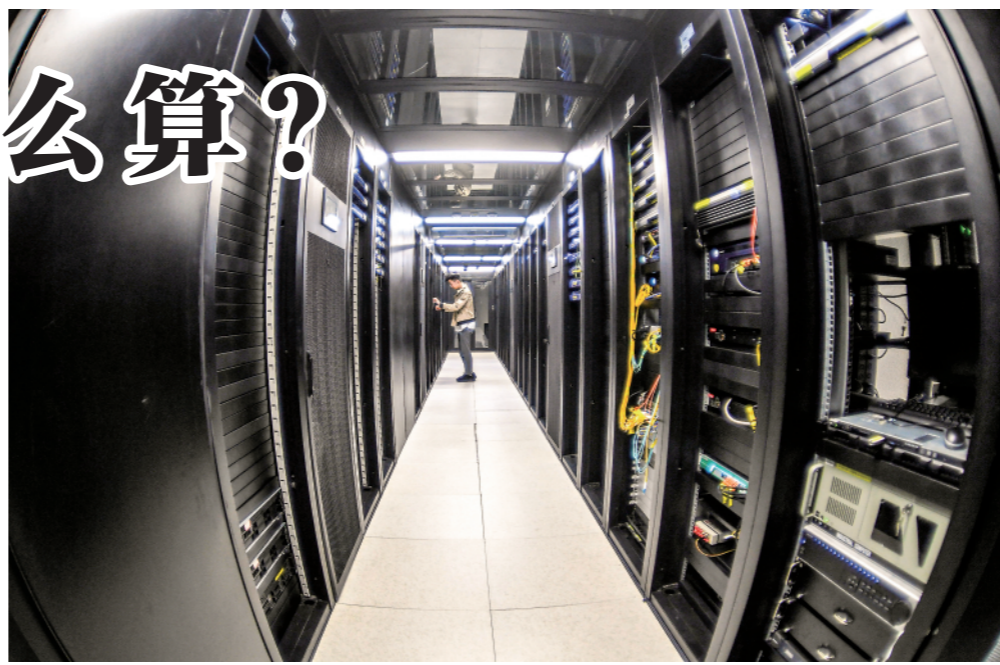
5月27日,工作人员在“一码贵州”数据平台机房检查设备运行情况。新华社记者杨文斌摄
