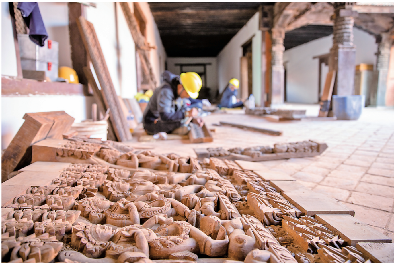
2019年10月10日,在尼泊尔加德满都杜巴广场,尼泊尔工人们在九层神庙修复现场工作。新华社记者张可任摄
