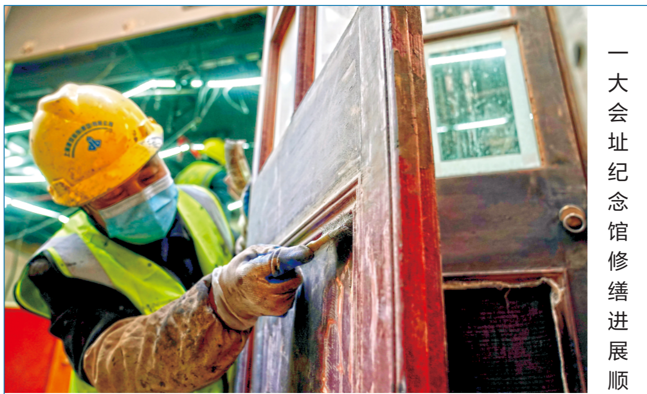
1月14日，工人在清理打磨门面上的木线条。 位于上海的中共一大会址纪念馆自2020年11月17日起暂停对外开放，实施修缮改造，目前工程正紧锣密鼓地进行中。“修旧如旧”后的百年石库门老建筑将以全新面貌，迎接建党百年。 新华社记者刘颖摄
