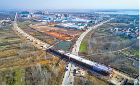
1月15日,武汉新港江北铁路倒水河特大桥跨天翔路连续梁最后一节段完成浇筑施工,工程建设有序推进。 新华社记者肖艺九摄
