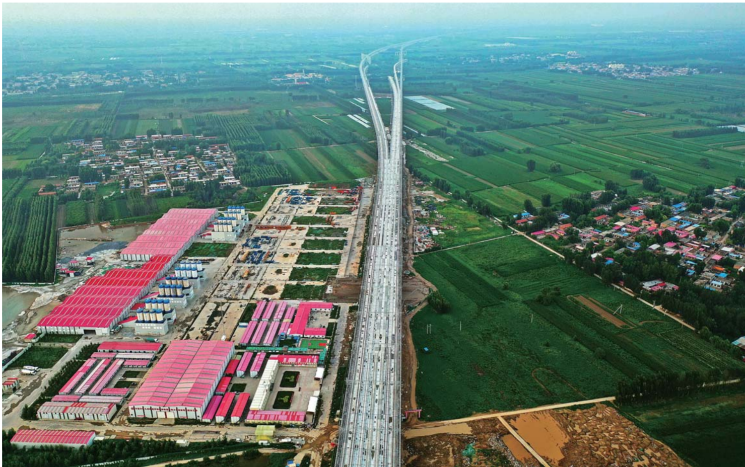
▲这是8月13日拍摄的雄安新区境内的京雄城际铁路建设现场(无人机照片)。
