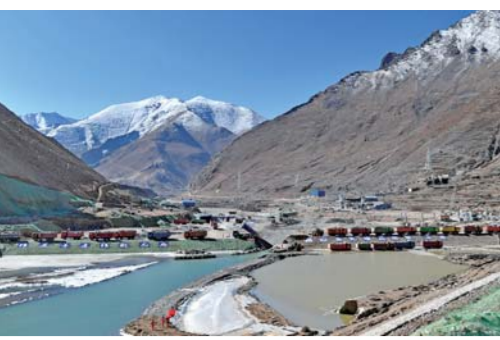
2月28日,西藏湘河水利枢纽工程成功截流,标志着湘河水利枢纽工程正式拉开主体工程施工作业序幕。 新华社记者张汝锋摄
