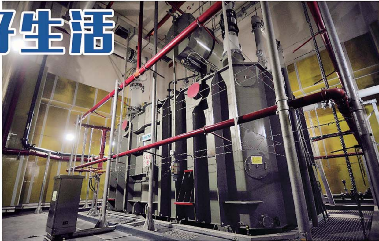
△500千伏五角场地下变电站的主变压器
