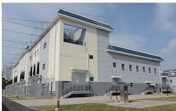
△改造后全新的220千伏新周变电站
