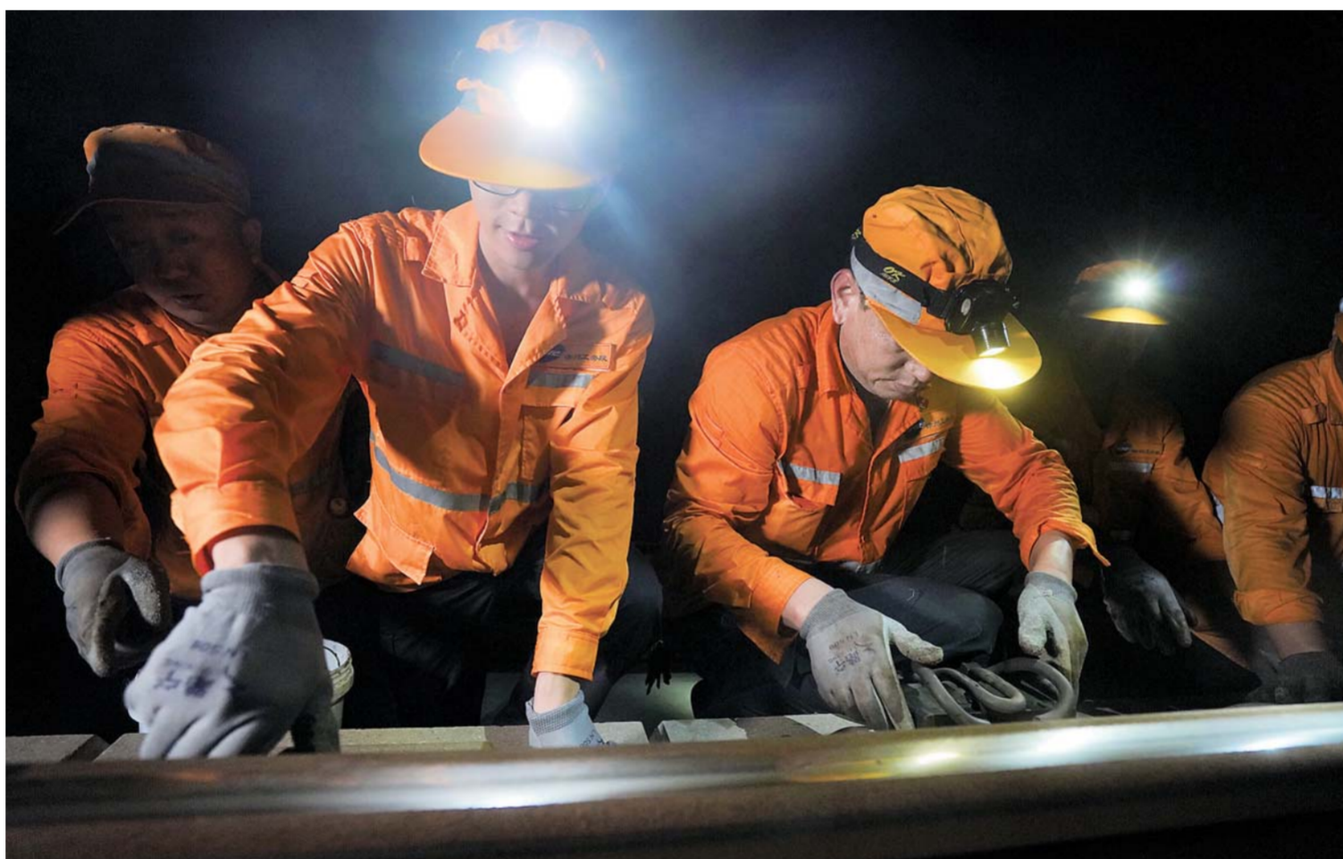
▲7月26日，中国铁路上海局集团有限公司徐州工务段的高铁线路工在进行“轨道精调”作业。新华社记者季春鹏摄
