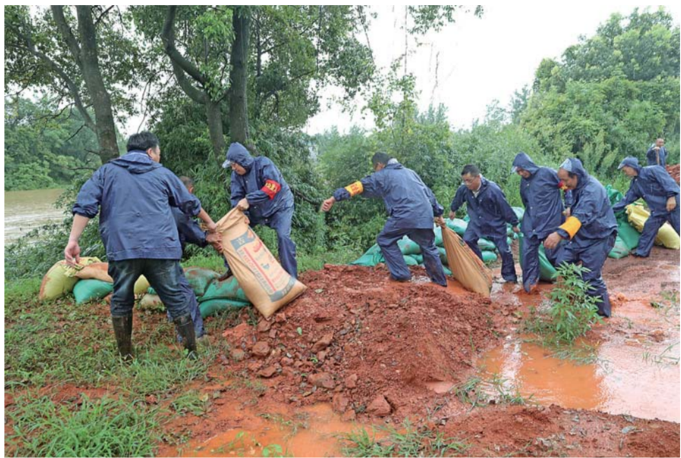
▲在江西省抚州市东乡区马坊镇桥西村,救援人员加固圩堤(7月8日摄)。连日来,江西省抚州市东乡区遭强降雨袭击,多个乡镇出现大范围积水内涝,部分乡村道路、农作物被淹。针对汛情,当地积极开展各项抢险救援工作。 新华社发(何江华摄)
