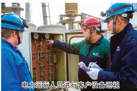
电力运行人员进行客户设备巡视
